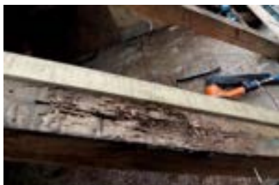
Obr. B-180 Mraveniště skryté mezi krokvemi a opláštěním
