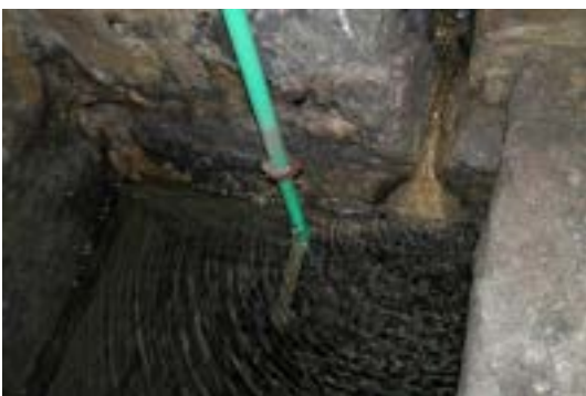
Obr. B-28 Částečné rozpadání pískovce
