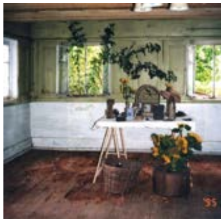
Obr. C-120 Plísní zničená prkenná podlaha v roubené světnici
