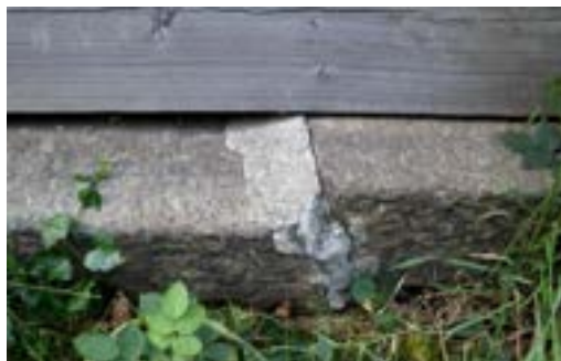
Obr. B-17 a Obr. B-18 Již dlouho existující poškození: prasklá podezdívka, na místech zlomu zajištěna kramlími vsazenými do olova, příp. zatřená hydraulickým vápnem
