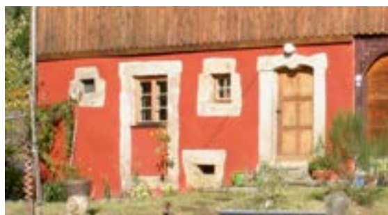
Obr. C-102 Nevhodné ztvárnění omítky s příliš sytou barevností a nelogickým a ahistorickým očištěním kamenných prvků, které vytváří na fasádě nepřirozené kontrasty.
