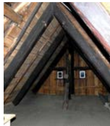
Obr. B-182: Nevhodné nepropustné obložení v podkroví
